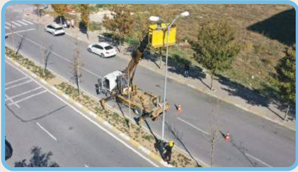
*OSMANLI CAD. ARIZALI ARMATÜRLERİN ONARILMASI - FEN İŞLERİ MD.
