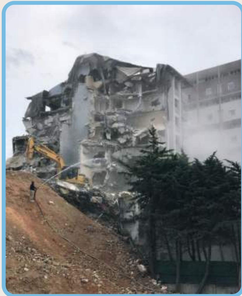
* KENTSEL DÖNÜŞÜM KAPSAMINDA YAPILAN YIKIMLARIN İNCELENMESİ - YAPI KONTROL MD.
