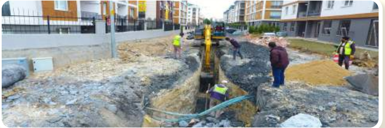
• KAVAKLI MAHALLESİ MUHAMMET CİNNAH SOKAK YAĞMUR SUYU KANAL ÇALIŞMASI - FEN İŞLERİ MÜD.
